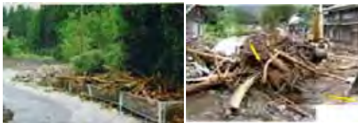
< 流木等による下流での被害 >
