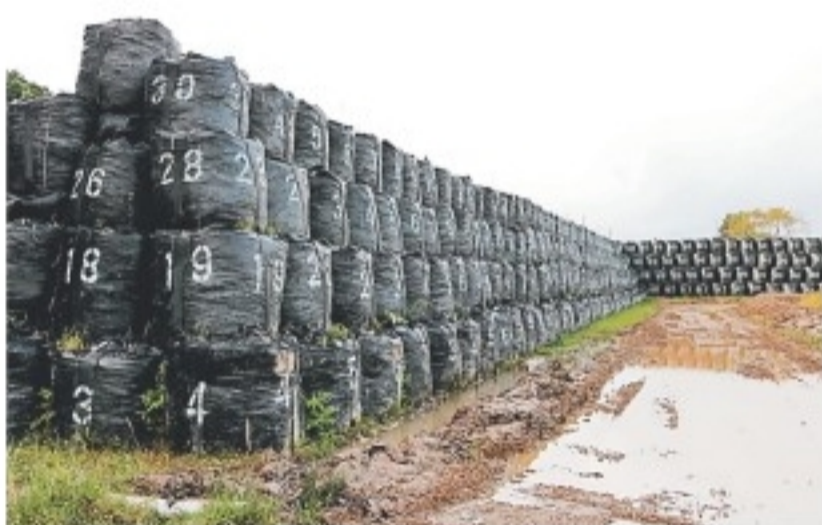
集落を囲む「輪中堤」の建設が予定される地区。臨時措置として土のうを積んだ壁ができています＝豊岡市日高町鶴岡
