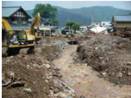
一乗谷川を閉塞した土砂の撤去状況 （22日撮影）
