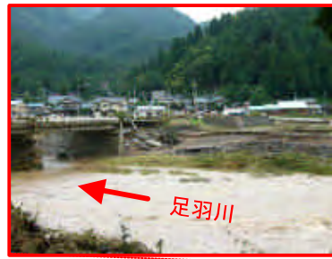
足羽川右岸堤防が護岸破損 （19日撮影）
