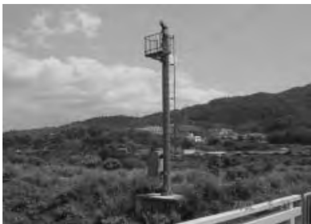
図4.4.9 監視カメラの設置状況（右岸岩出橋付近）
