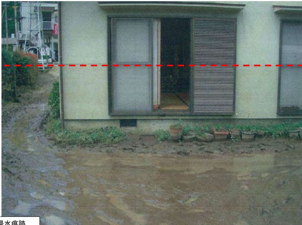
三津地区 浸水痕跡
