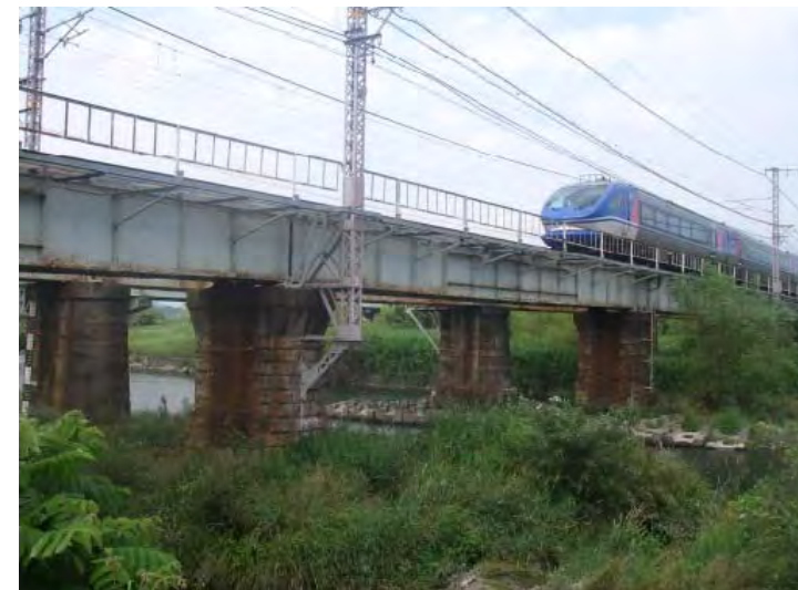
既存不適格の橋梁：JR山陽本線鉄道橋
