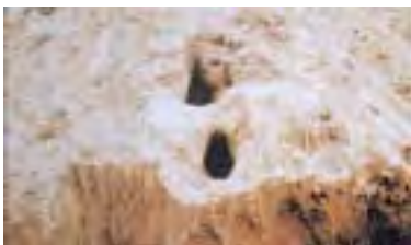
【堤防に掘られた穴】
