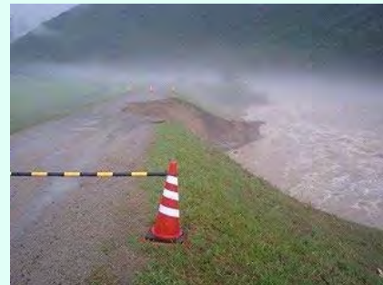
堤防欠損状況(宍粟市一宮町)
