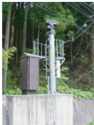
CCTV (テレビカメラ)
