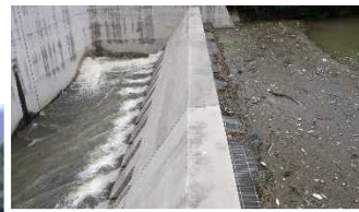
洪水時の放流状況
