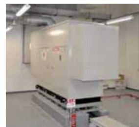
非常用発電設備のイメージ
