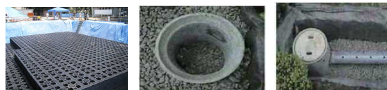
<雨水貯留浸透施設(左から貯留施設、浸透ます、浸透トレンチ)>
