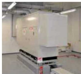
非常用発電設備のイメージ
