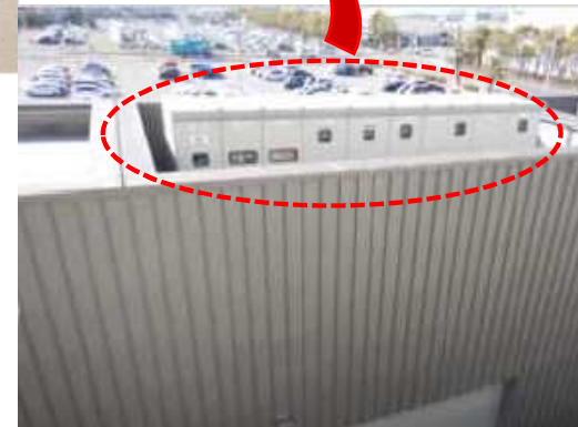
受配電設備・非常用発電設備の高所設置
