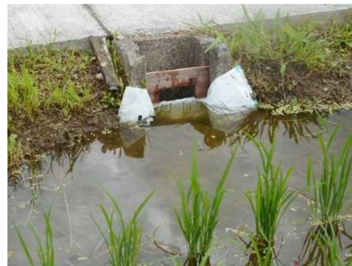
田んぼに設置された堰板
