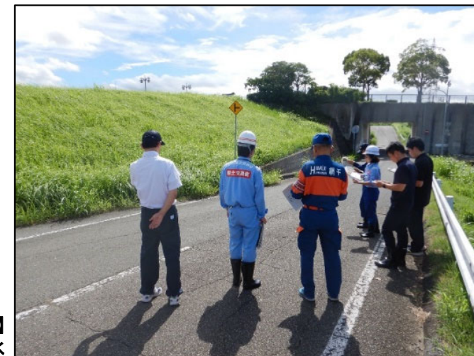
揖保川右岸2.2k付近 【姫路市との共同点検状況】 基礎地盤漏水
