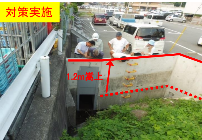
逆流により浸水した箇所の雨水枳の壁高を1.2m嵩上げ
