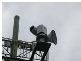
河川監視カメラ (CCTV)
