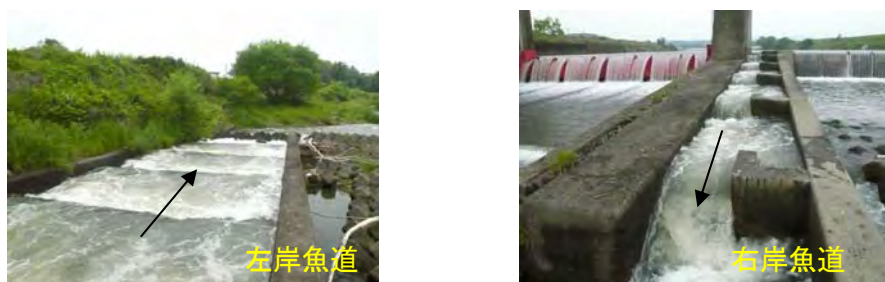
図-4.3.7 河合頭首工の魚道
