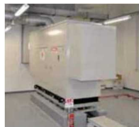
非常用発電設備のイメージ
