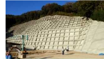
山腹崩壊防止を目的とした山腹工事の実施 (林野庁 兵庫森林管理署)
