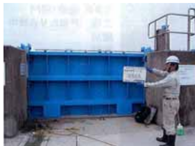
門扉動作確認
