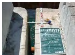
(目地開き状況)
