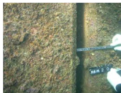
目地の開き ケーソン上部
