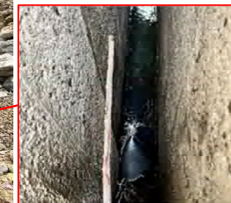
← 開削調査時(水面付近) 陸側から撮影 シート破損状況
