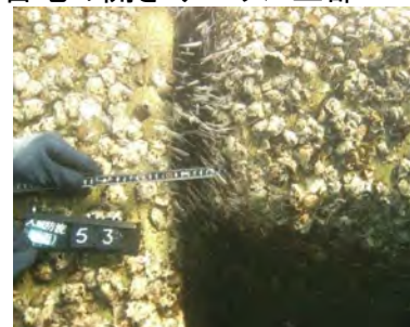
目地の開き ケーソン上部
