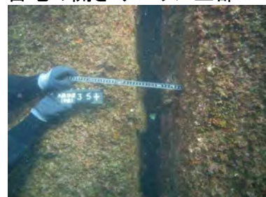
目地の開き ケーソン上部
