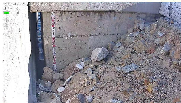
カメラ1 空洞箇所
