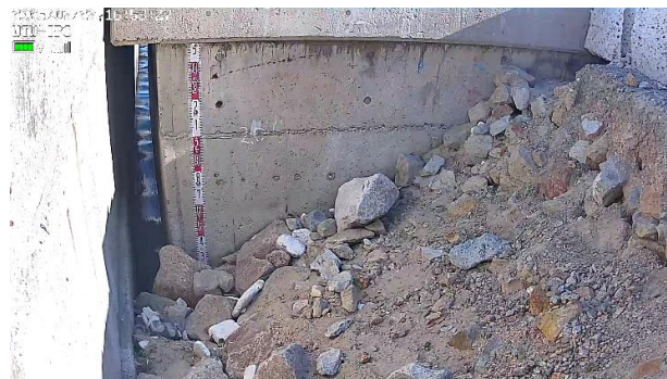
カメラ1 空洞箇所
