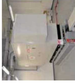
非常用発電設備のイメージ
