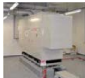
非常用発電設備のイメージ
