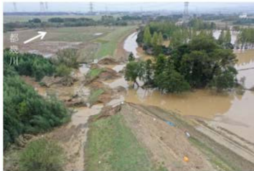
都幾川0.4km右岸 決壊箇所
