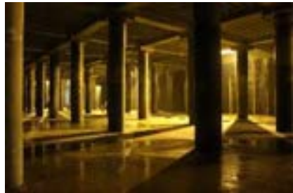
大規模地下貯留施設(下水道)
