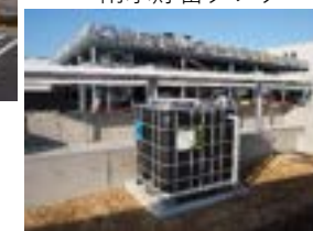
雨水貯留タンク
