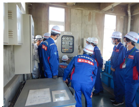
機側操作盤の説明
