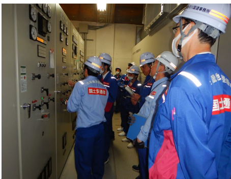
発電装置点検
