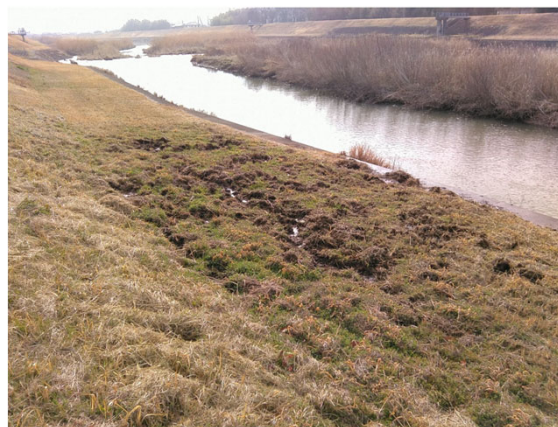
▲発見した堤防変状の確認
