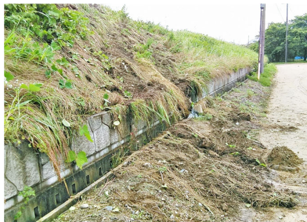
▲発見した堤防変状の計測
