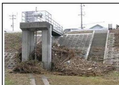
図 1.3.6 流木が河川管理施設へ引っかかっている状況
