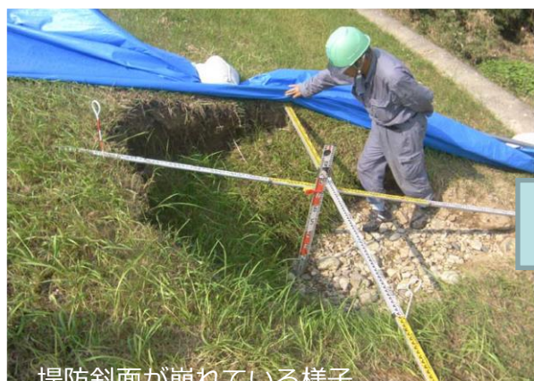
堤防斜面が崩れている様子
