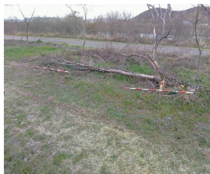
▲発見した堤防変状の確認
