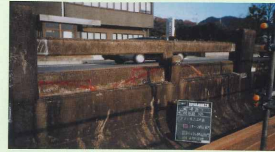
1.崩れて畳を挿入できない箇所や鉄筋が露出している危険な箇所をチェック
