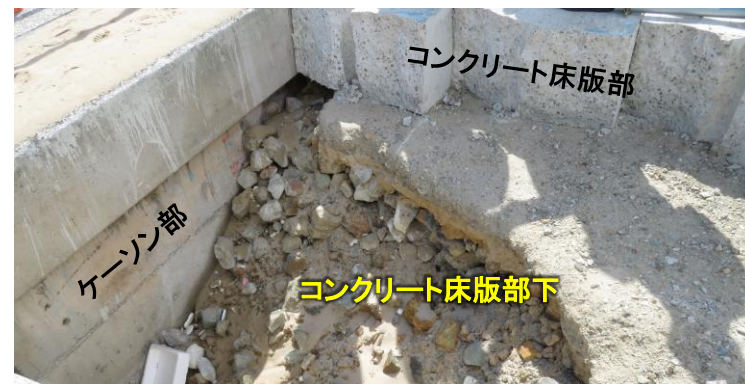
▲開削調査で確認されたコンクリート床版下の空洞 (写真は空洞最大箇所)
