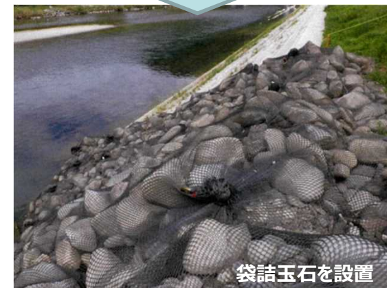
崩れた護岸への応急対応の様子 (野之上地区) 揖保川左岸36.4k付近
