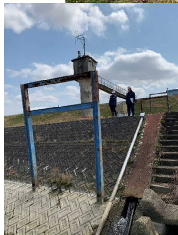
施設損傷確認の様子
