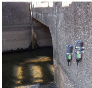
ワンコイン浸水センサ 設置状況①(加古川市)
