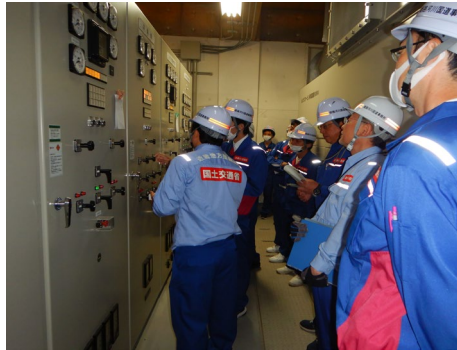
発電装置点検
