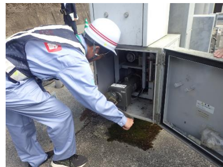
▲停電時を想定して手動で遮断機を操作。
