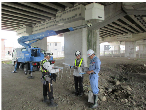
▲点検前の定期点検記録による点検内容の説明（玉手高架橋）
