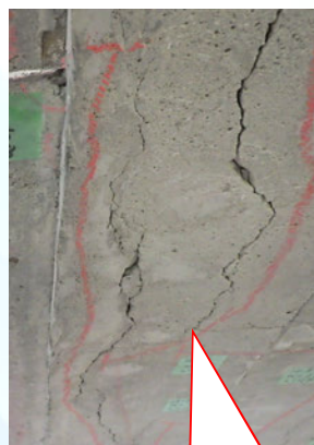
橋梁のひび割れ
