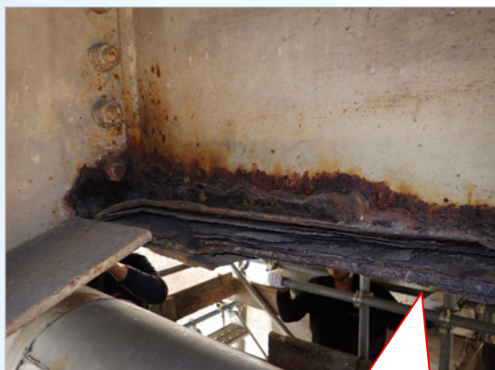
鋼桁の腐食が進行
