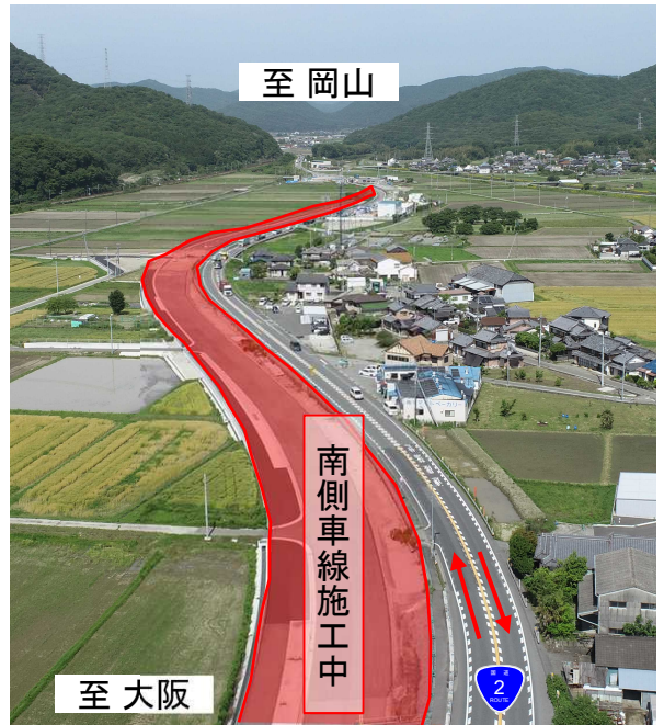
若狭野交差点付近・施工状況 ※現在・片側1車線通行、南側車線施工中
