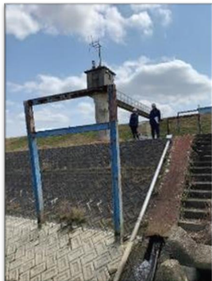
施設損傷確認の様子
