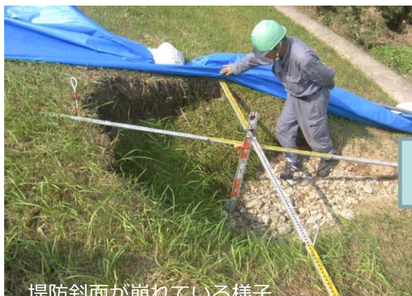
堤防斜面が崩れている様子
