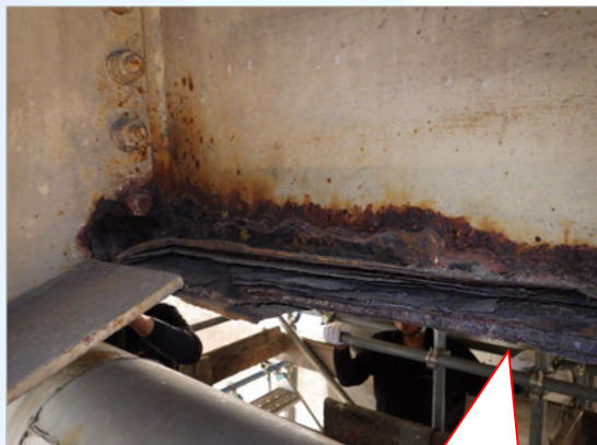
鋼桁の腐食が進行
