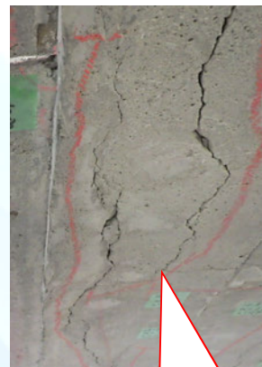
橋梁のひび割れ
