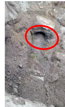
横断水路継ぎ目部に隙間が発生
