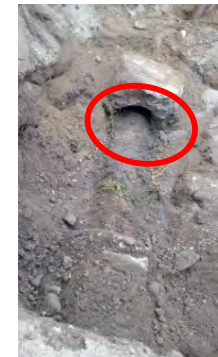
横断水路継ぎ目部に隙間が発生
