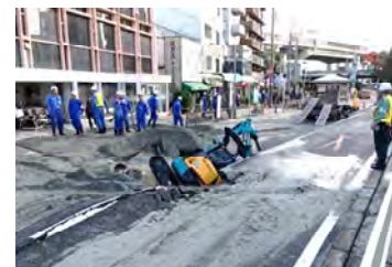
埋設管の老朽化に伴う道路陥没
