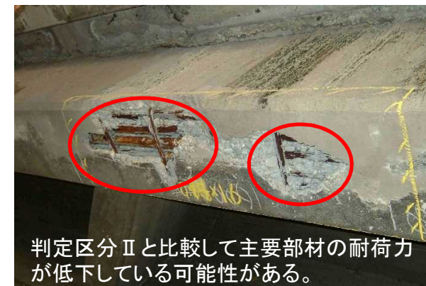
判定区分Ⅲ(主桁の断面欠損)
