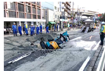
埋設管の老朽化に伴う道路陥没
