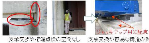
支承交換や桁端点検の空間なし 支承交換が容易な構造の例
