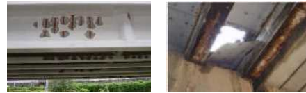
コンクリートの保護塗装後に剥離した例 鋼板接着により補強されたコンクリート床版が抜け落ちた例
